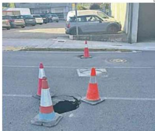
El socavón que se abrió este miércoles en la Avenida de Lugo de Cangas.
