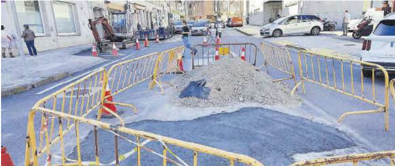
Operarios de la UTE Gestión Cangas trabajaron ayer en la reparación del socavón. | Santos Álvarez
