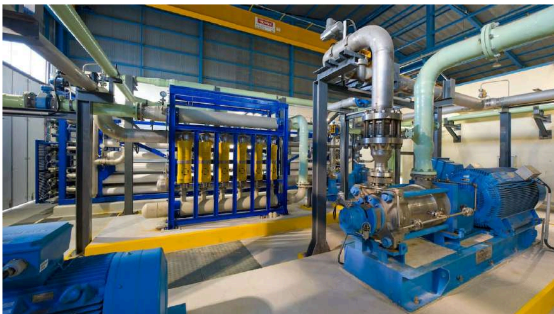
Imagen de una desaladora de agua de mar / Aqualia
